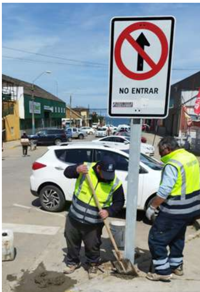
En las fotografías podemos ver: demarcaciones e instalaciones de señaléticas
